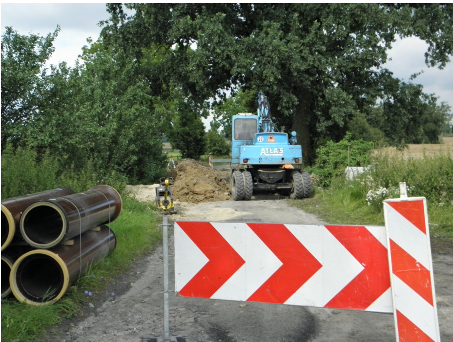
Początek robót związanych z budową kanalizacji grawitacyjnej w Łopuchowie (zadanie 6) przy projektowanej przepompowni PS2. Fot. Krzysztof Kańczkowski, Grontmij Polska Sp. z o.o.
