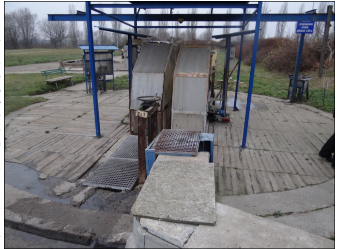
W ramach przedsięwzięcia „Kanalizacja obszaru Parku Krajobrazowego Puszcza Zielonka i okolic” z eksploatacji zostanie wyłączona oczyszczalnia ścieków w Pobiedziskach. Fot. Wioletta Frankowska
