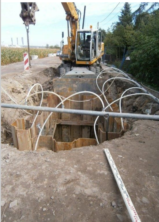
Paczkowo, ul. Pszczelna. Komora startowa przecisku rury kamionkowej \varnothing 300 . Fot. ZRUG Sp. z o.o.
