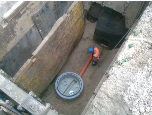
Na zadaniu 3 Wykonawca pracuje na dużych głębokościach. Na fotografii budowa kanalizacji grawitacyjnej na ul. Leśnej w Jerzykowie. Fot. TAHAL POLSKA Sp. z o.o.
